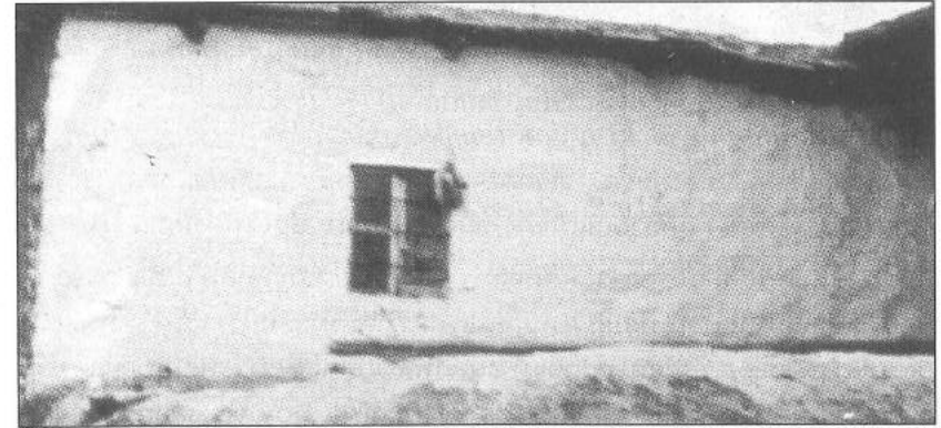
Resim 9. İçinde tremolite asbest bulunan dış duvanı ak toprakla sıvanmış bir köy evi.
